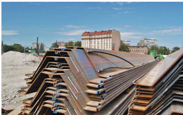
Fot. 5 Grodzica z przymocowanymi rurami wykonanymi z twardego PCV przygotowana do pogrążania z podpiukiwaniem
